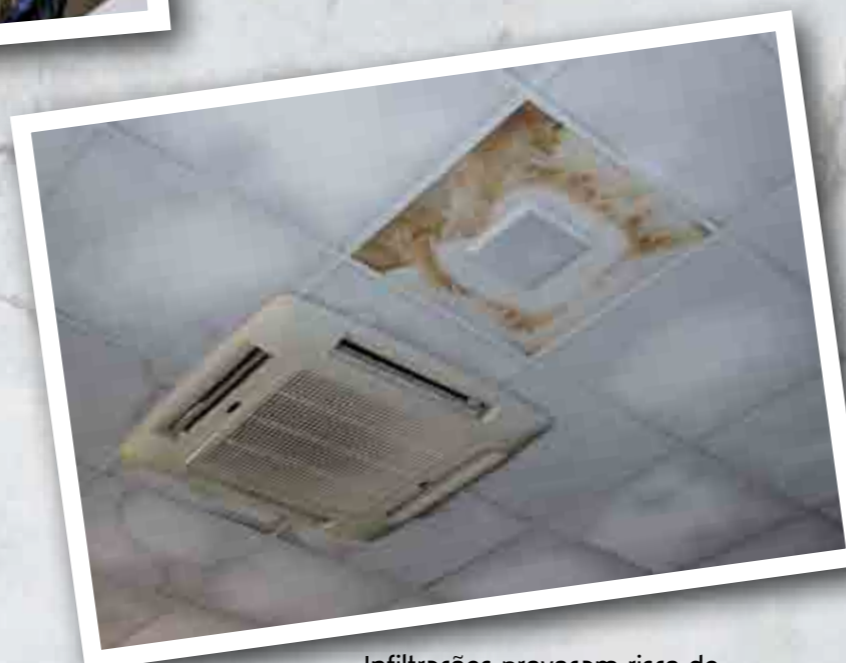
Infiltrações provocam risco de curto-circuito no plânrio
